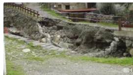
Dopo la pioggia si contano i danni. http://www.youreporter.it/video_Dopo_la_pioggia_si_contano_i_danni
